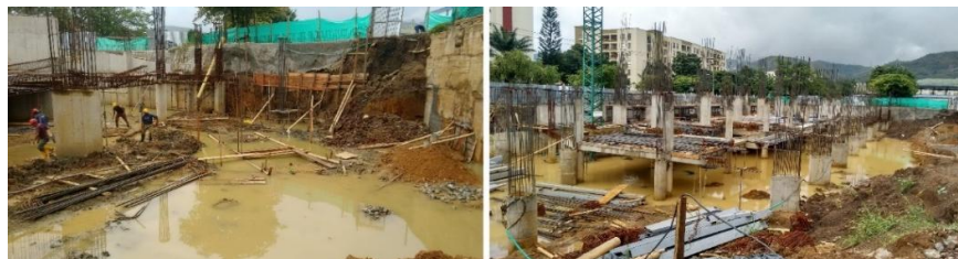
Figura 8. Fotografías que evidencian inundaciones. Fuente: Gabriel Saldarriaga.
