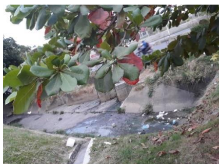
Figura 3. Se evidencia el mal uso que los habitantes hacen de los canales de aguas lluvias, disponiendo residuos en ellos
