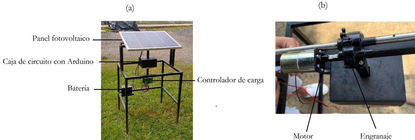
Ilustración 6 Sistema fotovoltaico autónomo con sus componentes (a) vista completa (b), vista del sistema mecánico de seguimiento.
