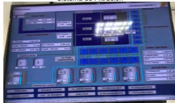
Automatización de la PTAP Río Cali
