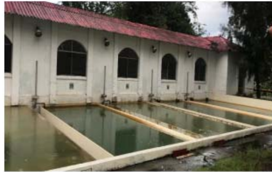
Sistema de Filtración
